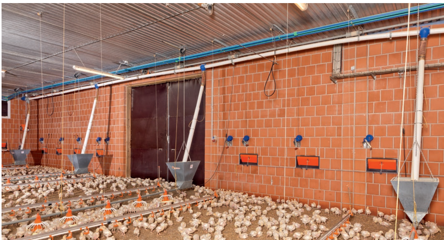
Применение кабельных лебедок для настройки оптимальной высоты линий поения соответственно возрасту птицы
