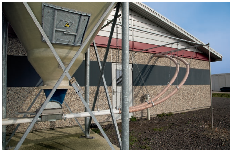
Применение FlexVey PUR в сочетании с жесткой трубой FlexVey
